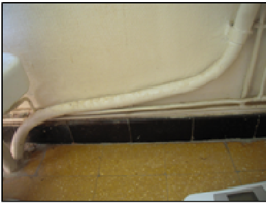
Conduit en plomb
