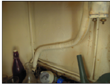
Conduit en plomb
